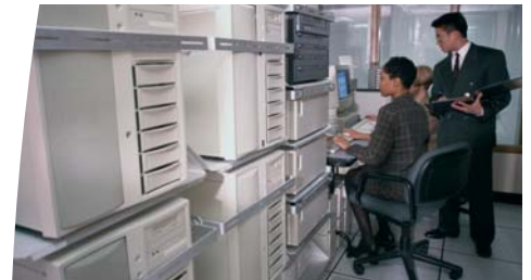
Datenzentren: Serverräume, Kommunikationszentren, Speicherlaufwerke, Netzwerkkomponenten.
