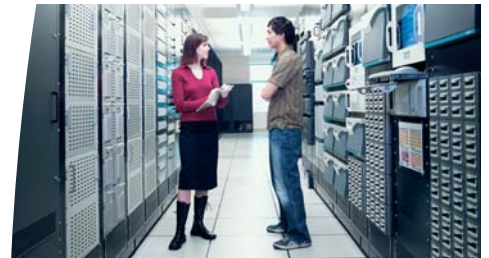
Datenzentren: Serverräume, Kommunikationszentren, Speicherlaufwerken, Netzwerkkomponenten.
