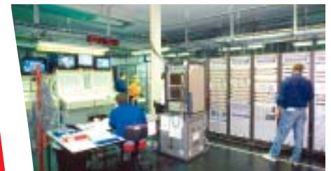
Industrielle Prozesse: programmierbare Steuerungen, Schaltzentralen, Gebäudeautomation ...
