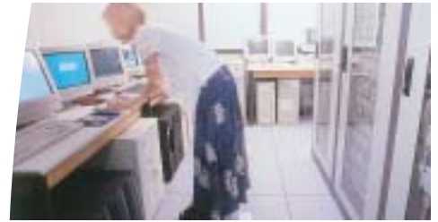
Server und Datenspeicherung, aktive Netzwerkkomponenten
